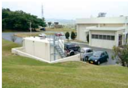
レストランのボイラー用 (沖縄米軍基地)
