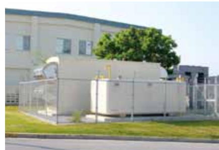
電話局発電機 (沖縄米軍基地)
