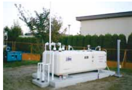
自家発電機用 (米軍岩国基地)
