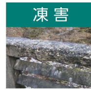
微細ひび割れ、スケーリング、ポップアウト、変形
