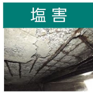
鋼材軸方向ひび割れ、さび
