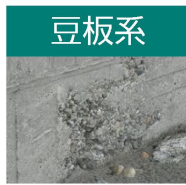
豆板、摩耗(すりへり)
