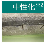
鋼材軸方向ひび割れ、塩害、中性化、コンクリート剥離
